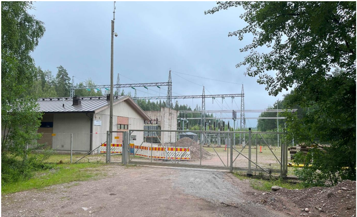
Kuva 9. Muuntamo kuvattuna etelään.
